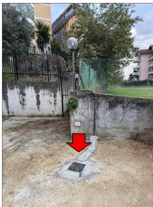
Figura 48 – Piezometro elettrico Pz5.
