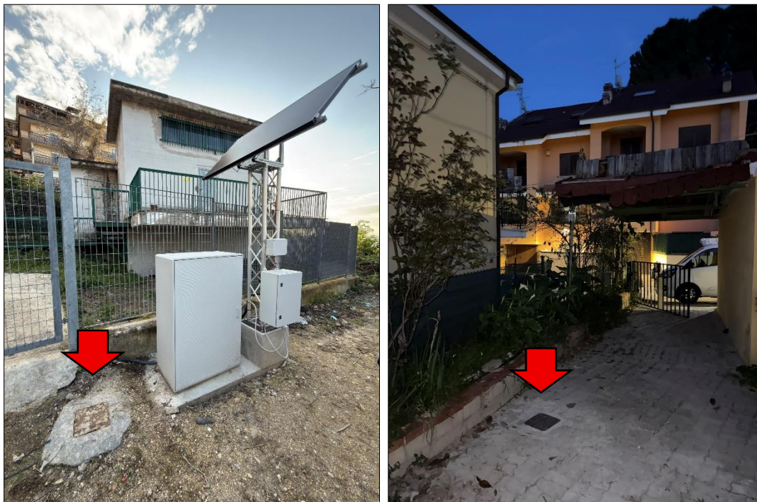
Figura 47 – Piezometri elettrici Pz3 e Pz4.
