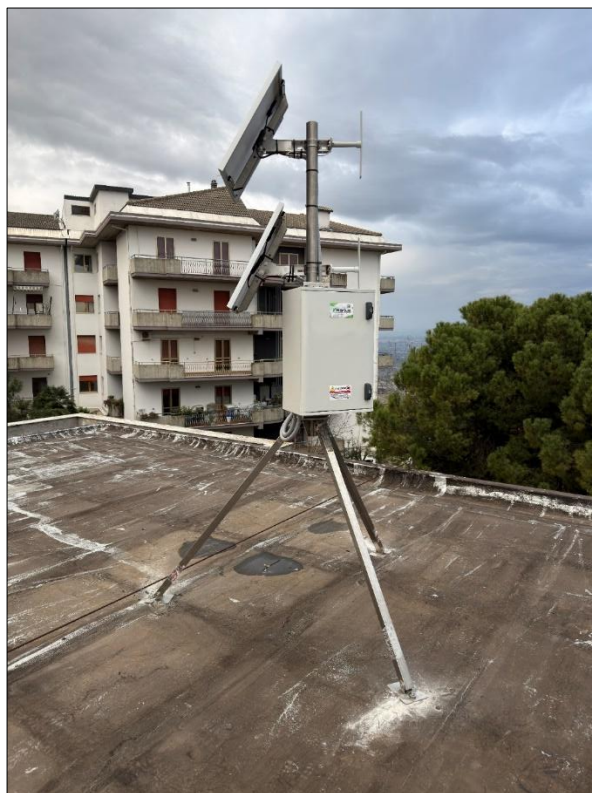
Figura 25 – Centralina di acquisizione e sistema di trasmissione remota.
