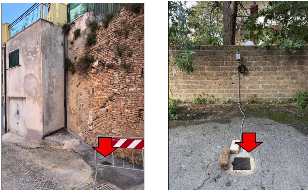
Figura 46 – Piezometri elettrici Pz1 e Pz2.
