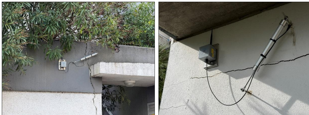
Figura 44 – Fessurimetri F09 e F10.
