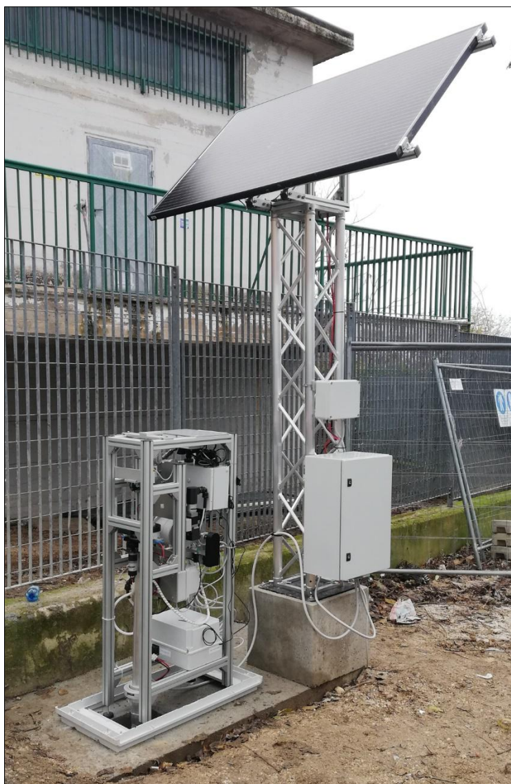
Figura 50 – Inclinometro Robotizzato AIS installato sulla postazione I3.
