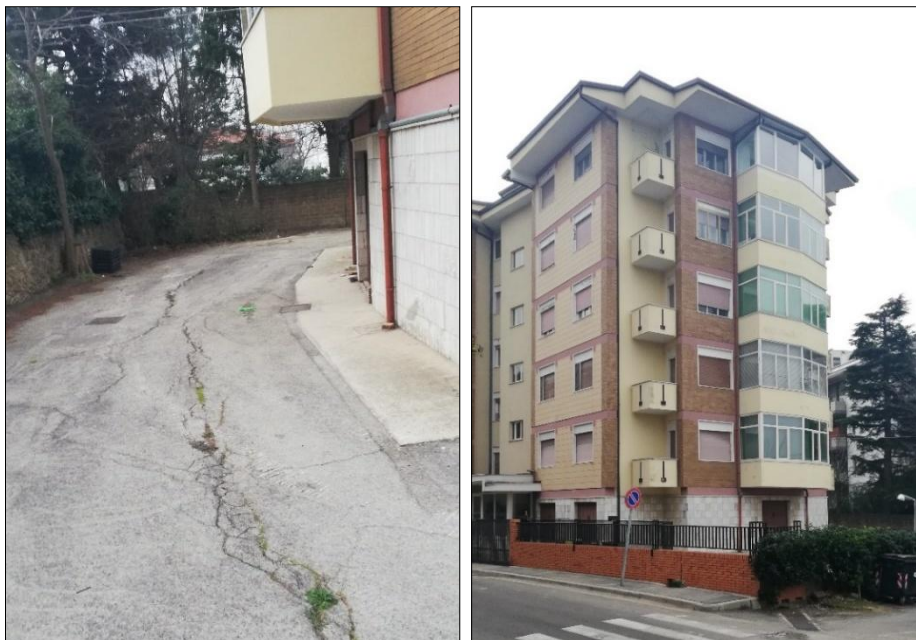
Figura 3 – Condominio al civico 121 ed evidente rotazione
